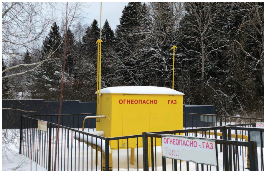
Рис. 7. Газорегуляторный пункт ГРП
