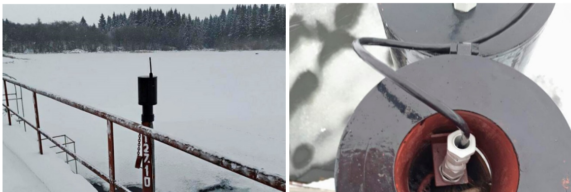
На фото: Установка АВТОНОМНОГО датчика контроля уровня на бьефе водохранилища
